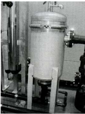
写真6 抗菌剤通水塔
